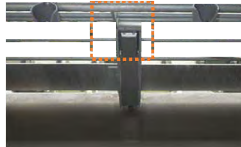
車いす充電用蓋付コンセント
