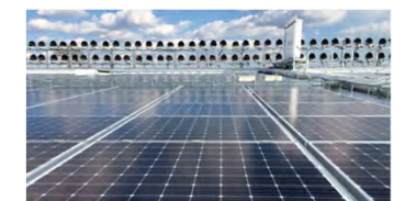
太陽光発電設備
